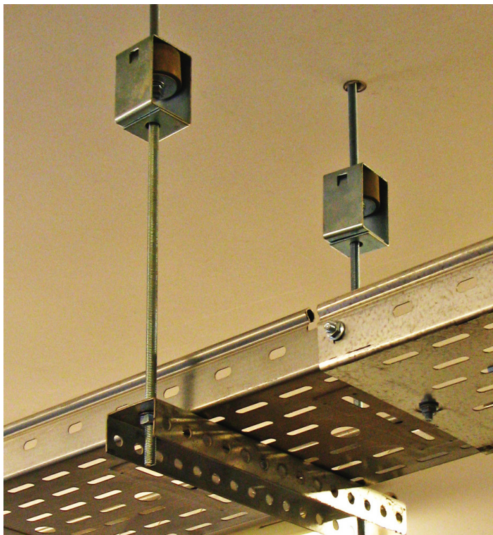
Виброизоляция лотков кабельных сетей
